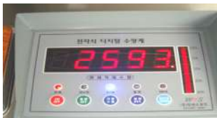
[그림 V-286] 펌프 조작반 수량계
