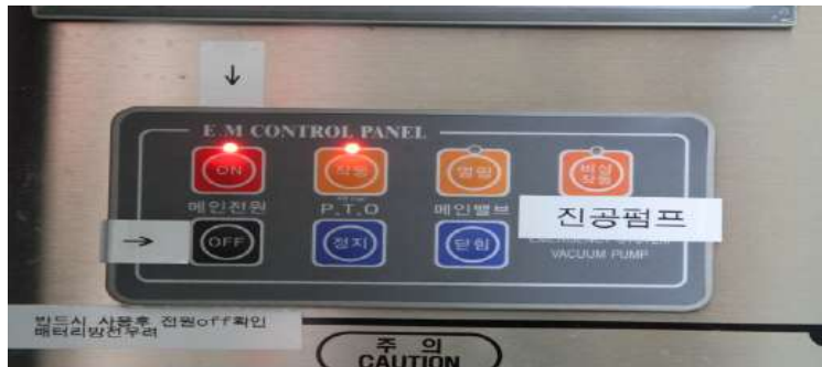
[그림 V-248] 펌프조작반에 설치된 비상작동 조작스위치
