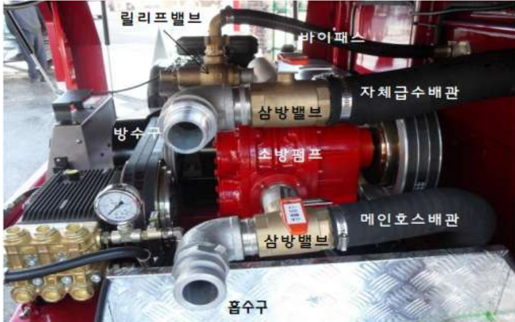
[그림 V-185] 소방펌프 및 주변장치
