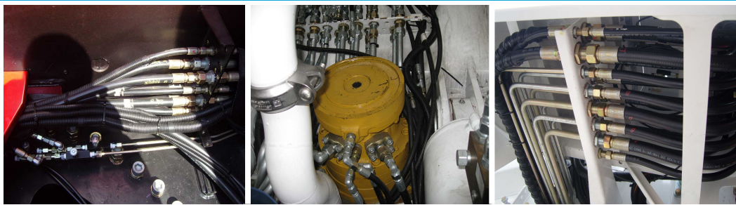
[그림 2-50] 소방 고가 · 굴절차 유압호스 누유 확인
