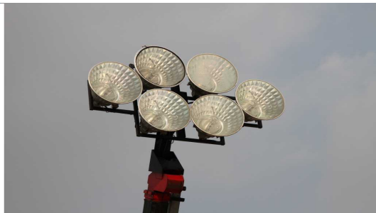
조명등 점등, 파손 여부 확인
