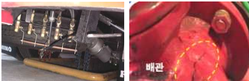
[그림 3-49] 자동 배수밸브(좌) 배수불량 동결 파손사진(우)
